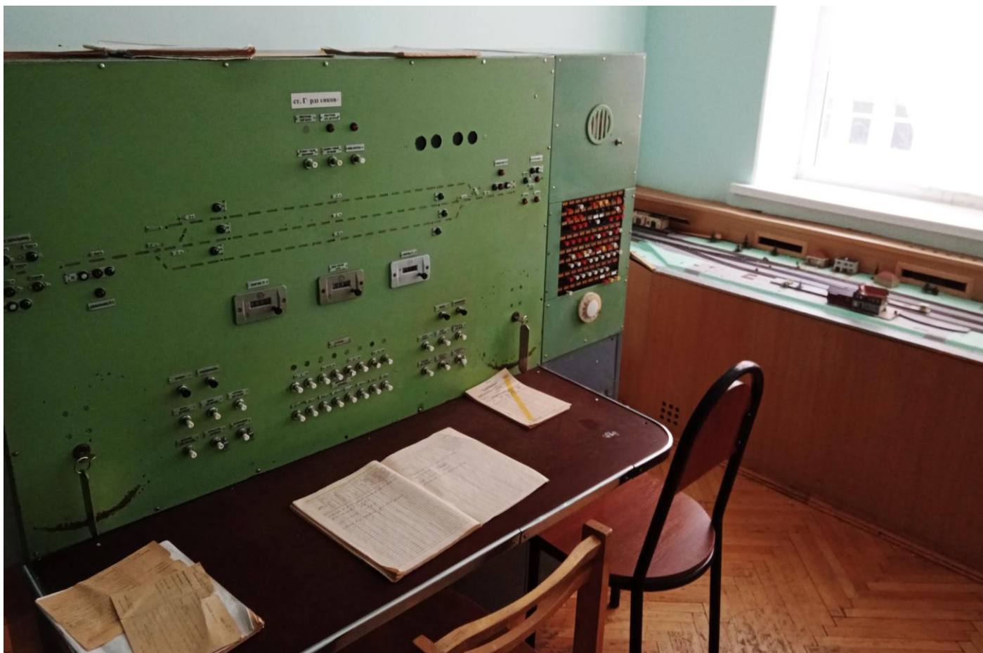
Робоче місце чергового по станції Гордієнкове на одноколіній дільниці, аудиторія № 4409
